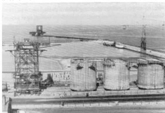
Den store skotske kran var nået ud på østre ydermole. I forgrunden tre af de kæmpemæssige beton-elementer. (Foto: Jens Steffensen).
