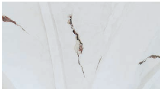
Revnedannelser i hvælvingerne.
